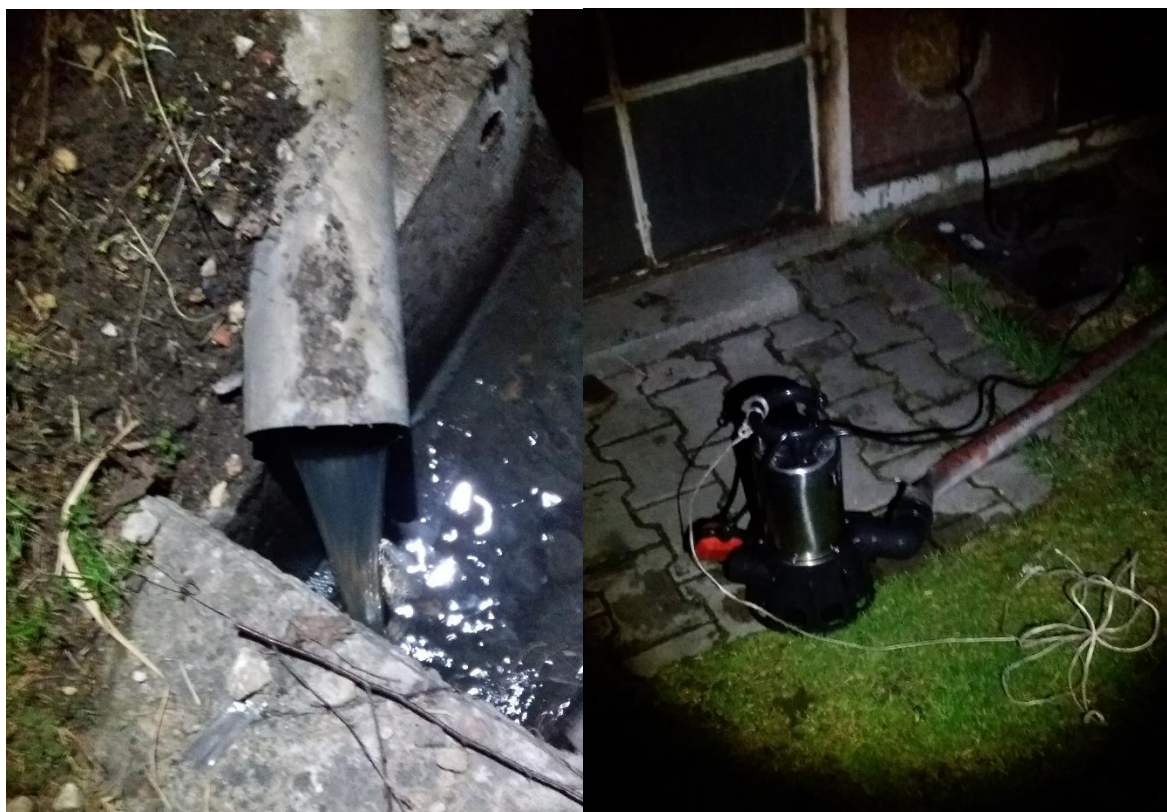
Foto. 7. EKO-PATROL podczas kontroli opróżniania zbiorników na nieczystości ciekłe – nocny zrzut ścieków ul. Hrubieszowska
