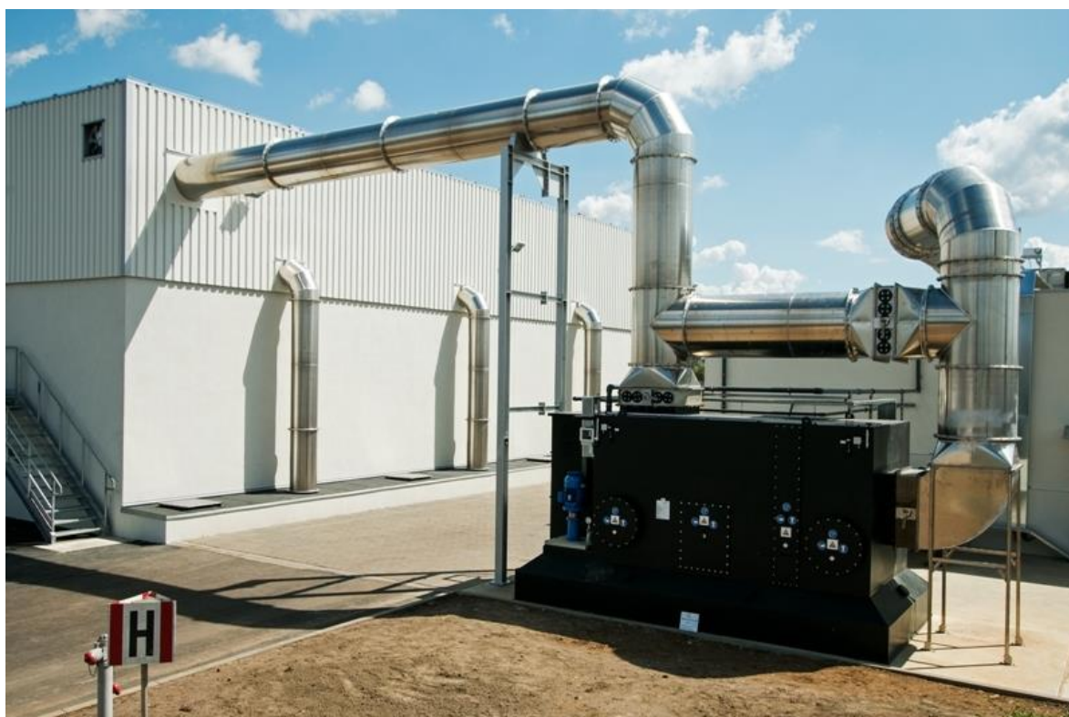
Foto. 1. RIPOK – Lipówka II w Dąbrowie Górniczej – instalacja do kompostowania odpadów biodegradowalnych.
