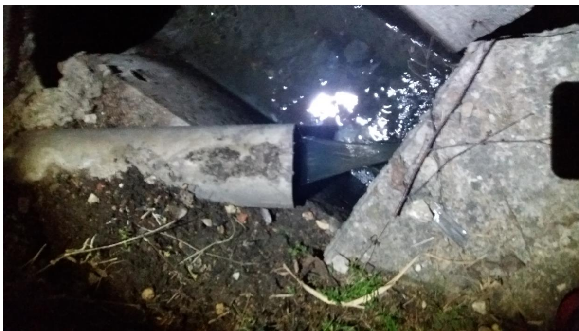
Rysunek 18. Nocna kontrola na ulicy Hrubieszowskiej – nielegalny zrzut ścieków do rowu
