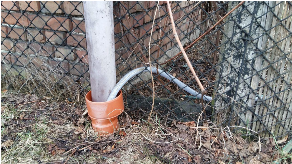
Ryc. 6. Kontrole szamb – pompowanie ścieków przez system kanalizacji deszczowej bezpośrednio do ciekę wodnego
