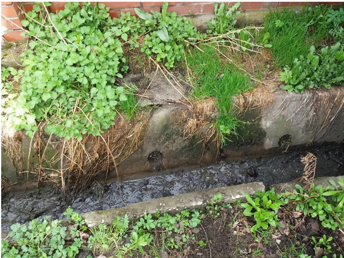
Ryc. 7. Kontrole szamb – zrzut ścieków do rowu przydrożnego Owocowa
