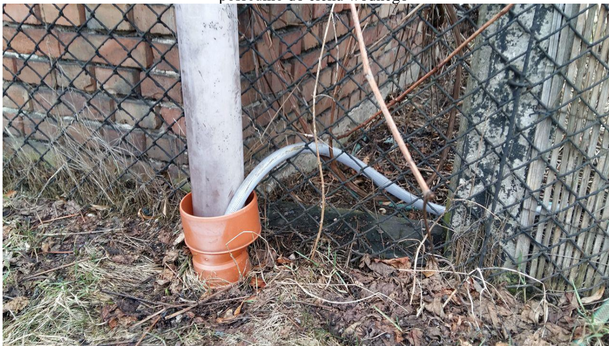
Ryc. 6. Kontrole szamb – pompowanie ścieków poprzez system kanalizacji deszczowej bezpośrednio do ciekę wodnego
