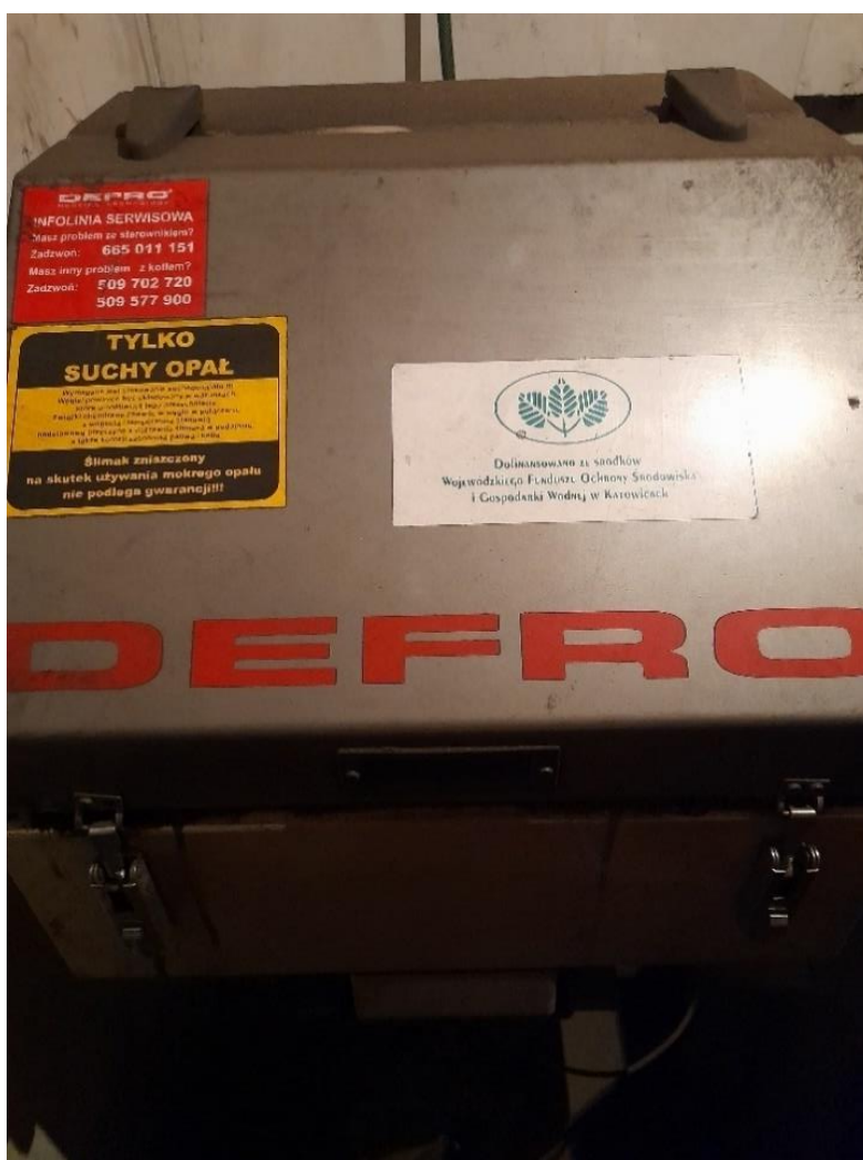
Zdj. 1. Piec na paliwo stałe zakupiony w ramach dotacji przyznawanej z WFOŚiGW. Zdjęcie wykonane podczas jednej z kontroli zrealizowanej przez UM Sławków (źródło: materiały własne).
