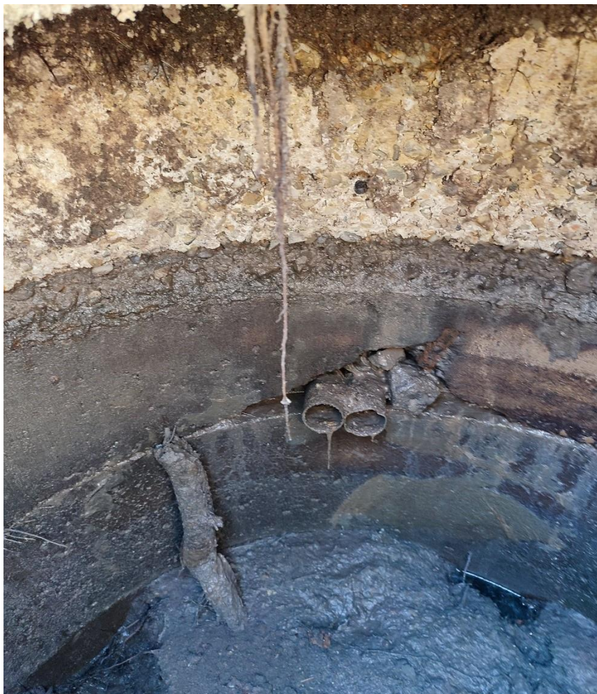
Zdj. 14. Kontrola nielegalnych wylotów ścieków ( źródło: materiały własne ).
