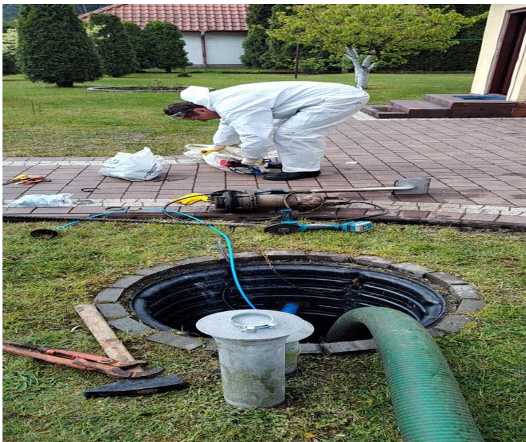
Rysunek 11. Awaria przydomowej przepompowni
